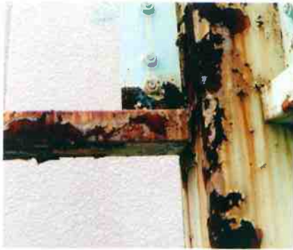
錆びたアングル
