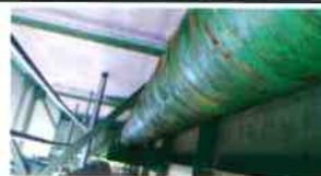
①錆の現状
