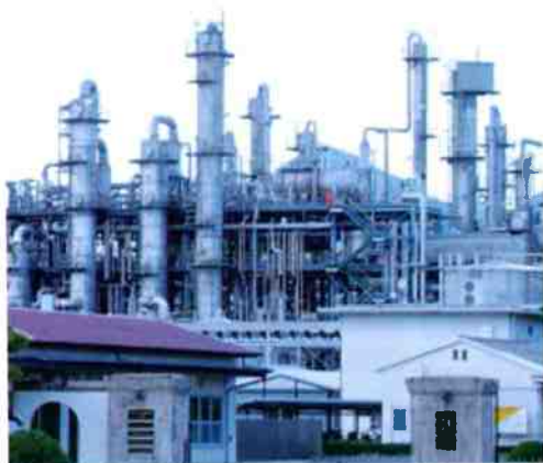
化学工場 製造設備等に使用
