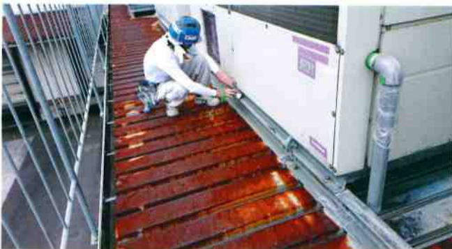
錆びた折板屋根
