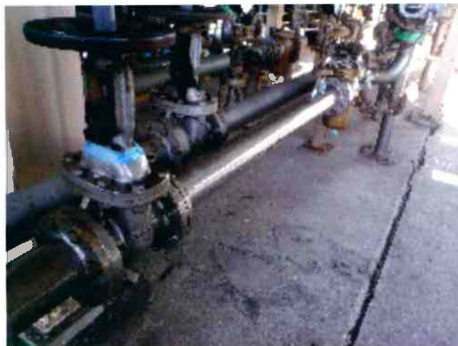
燃料パイプ系の複雑な配管ラインに応用
